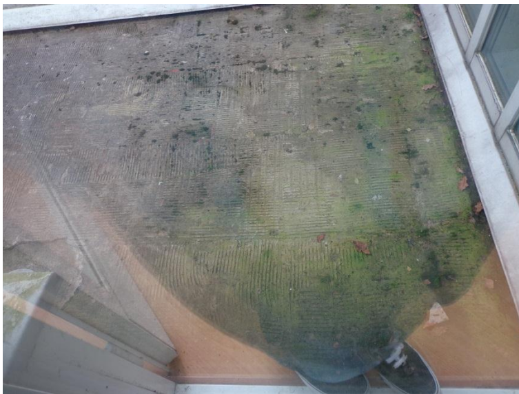
Kuva 49. Parvekelaatta tulisi korjata.
