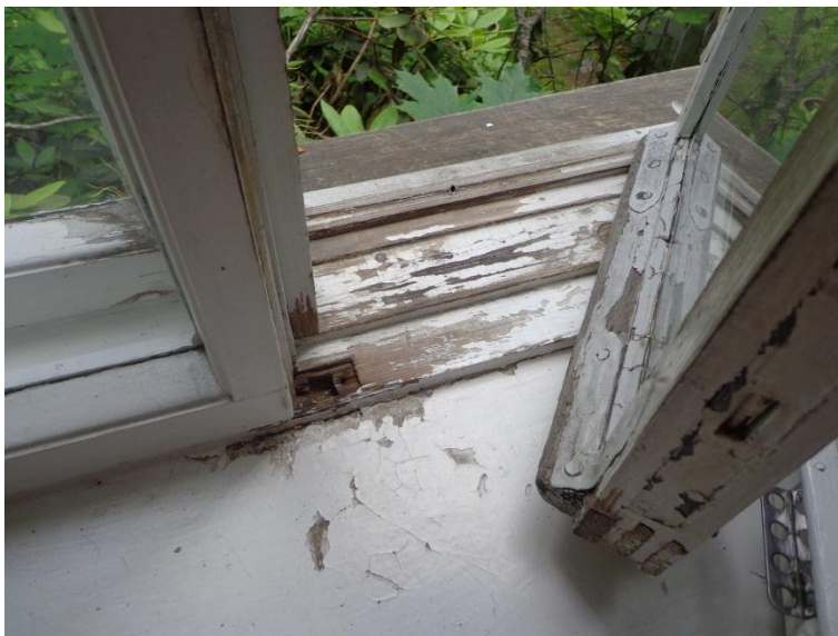
Kuva 81. Ikkunat on suositeltavaa uusia.
