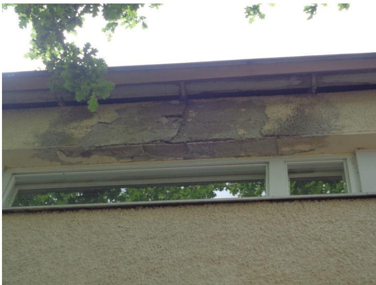
Kuva 32. Vuotanut ränni vaurioittanut seinärakennetta
