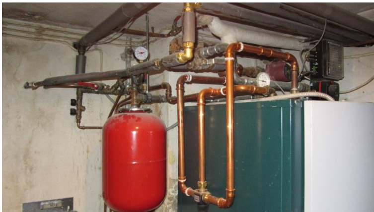
Kuva 95. Vuonna 2008 uusittu lämmöntuotantojärjestelmä
