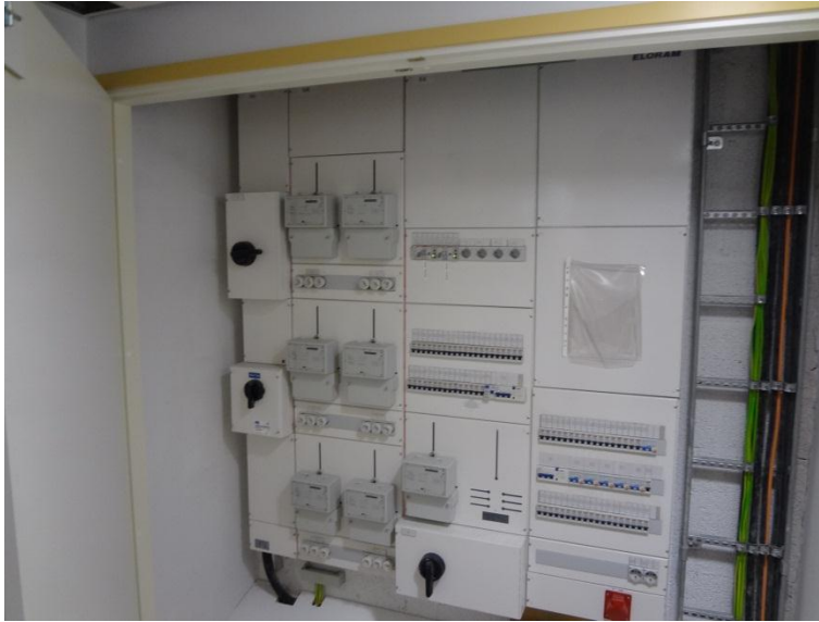
Kuva 75. Rakennuksen 6 pääkeskus ja koko sähköverkko kojeineen on uusittu vuonna 2006 – käyttötarkoituksen säilyessä rakennuksessa ei ole tarpeen tehdä sähköasennusten muutoksia tai korjauksia.
