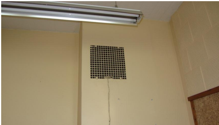
Kuva 10. Painovoimaisen ilmanvaihdon poistosäleikkö kivirakenteisessa hormissa
