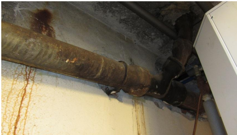
Kuva 84. Alkuperäinen valurautaviemäri on huonokuntoinen
