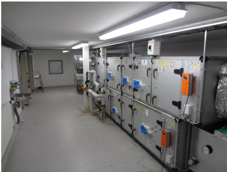
Kuva 22. Ullakolla sijaitsevat IV-koneet ja niiden sähkökeskukset ovat asennettu vuonna 2005
