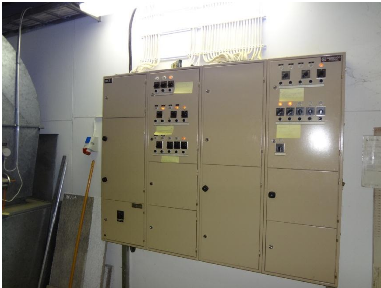
Kuva 57. Rakennuksen 3 ryhmäkeskusten teknistä käyttöikä on huolto- ja korjaustoimenpitein lisättävissä yli 10 vuotta.
