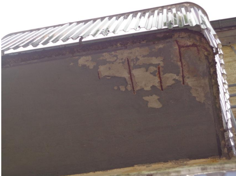
Kuva 65. Parvekkeet tulisi peruskorjata.
