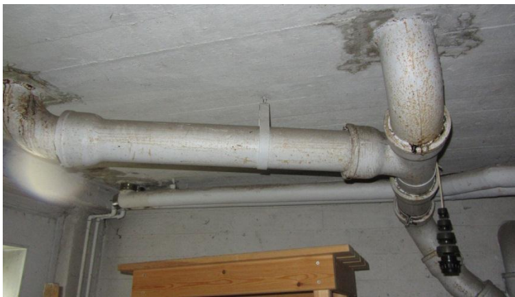
Kuva 44. Alkuperäisissä valurautaviemäreissä nähtävissä vuotojälkiä
