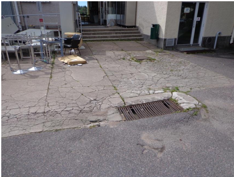
Kuva 17. Pihalaatat ovat vaurioituneet ja vesi lammikoituu.
