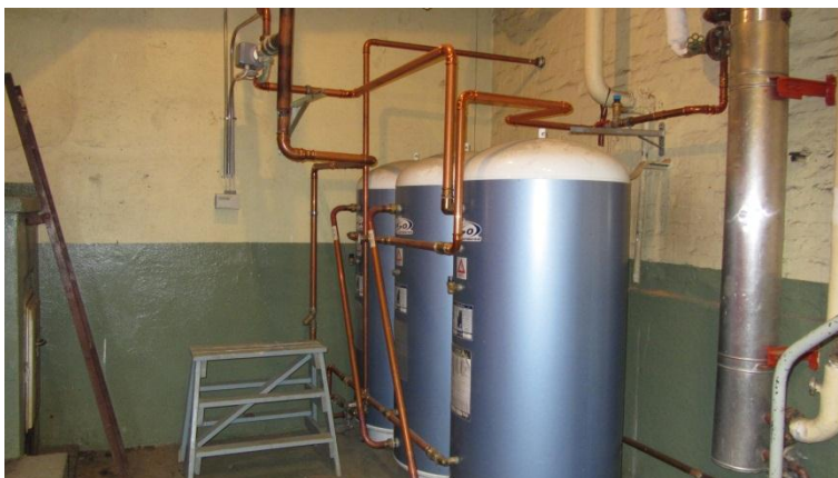
Kuva 19. Vuonna 2009 uusitut lämminvesivaraajat
