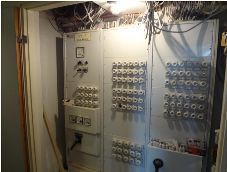
Kuva 34. Rakennuksen 1 osan C nousukeskus on asennettu vuonna 1992. Keskus on TN-S järjestelmän mukainen ja sen teknistä käyttöikää on huoltotoimenpitein lisättävissä yli 10 vuotta. Keskus on käyttökelpoinen myös tilojen käyttötarkoituksen muuttuessa.
