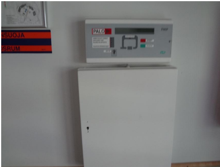
Kuva 77. Rakennuksen tilat on suojattu osoitteellisella paloilmoitusjärjestelmällä.
