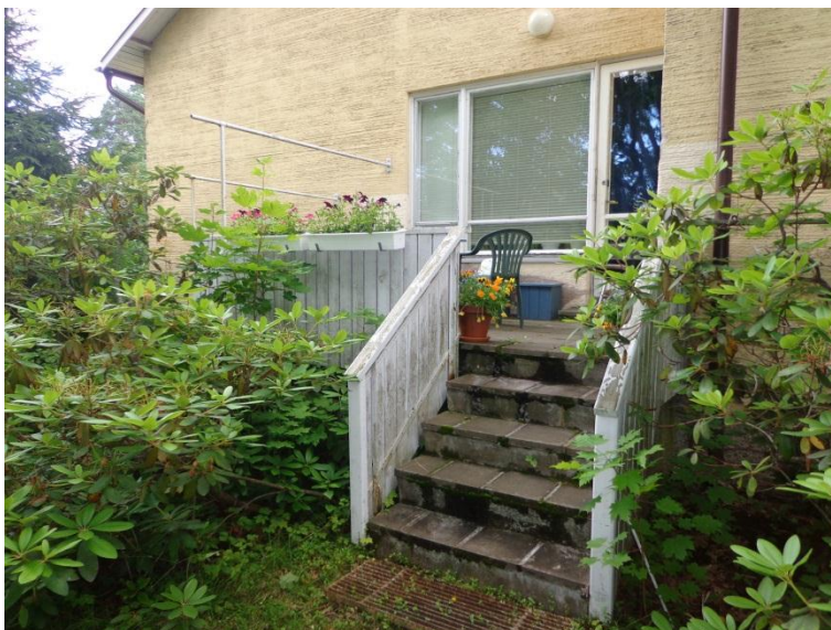
Kuva 82. Puuosat tulisi vähintään huoltomaalata.
