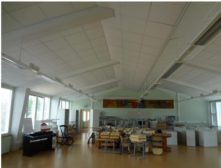
Kuva 28. Opetustilojen valaistusasennukset ovat hyväkuntoisia. Kellarikerroksen valaistusryhmäjohdot ja kojeet ovat pääosin uusittavassa kunnossa.
