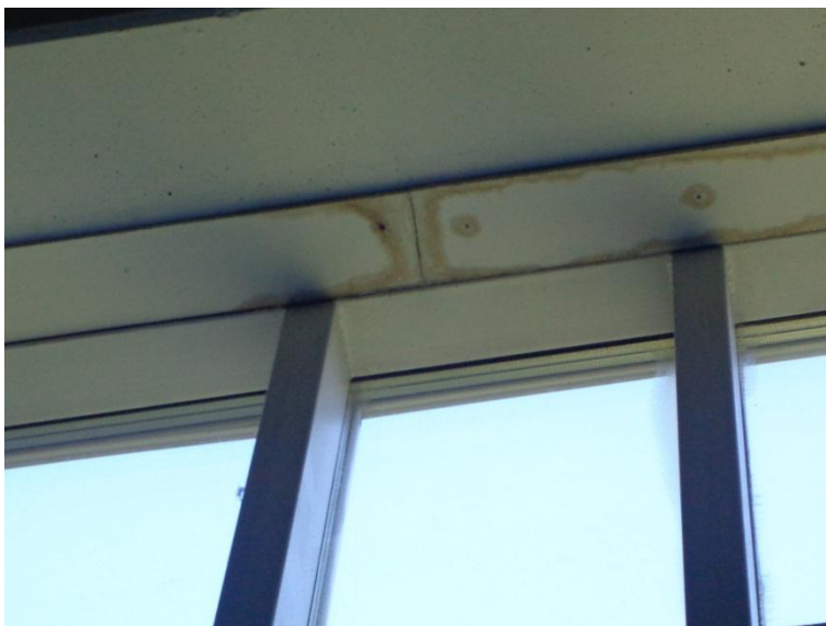
Kuva 51. Liikuntasalin yläikkunoiden kohdalla näkyy vuotojälkiä.
