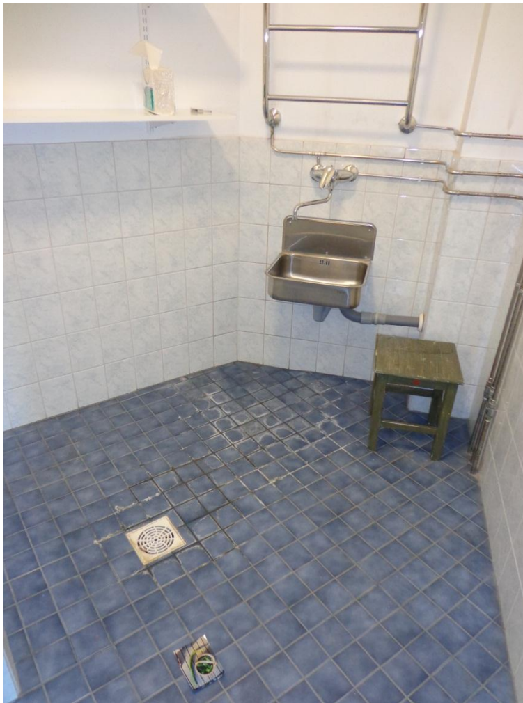
Kuva 15. Siivouskammeron rätipatteri vuotaa.
