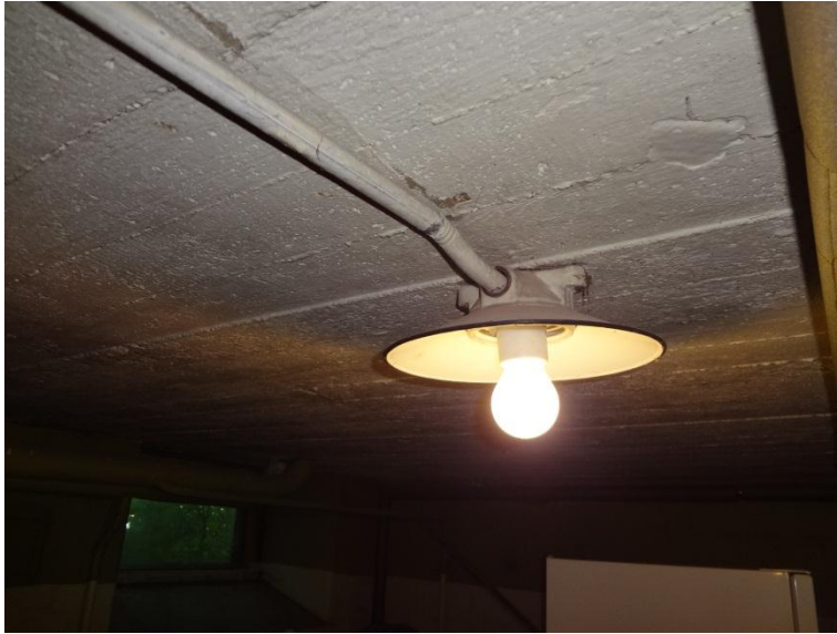
Kuva 87. Kellarikerroksen varastotilat ja asunto A on sähköverkon kokonaissaneerauksen tarpeessa.
