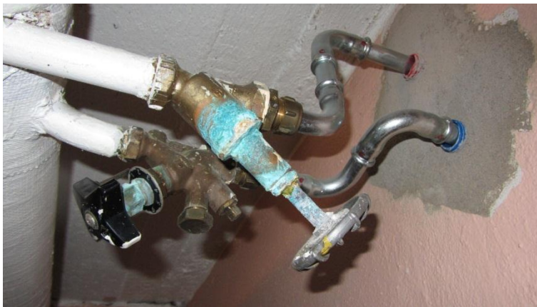
Kuva 41. Alkuperäiset lämmitysjärjestelmän sulku- ja säätöventtiilit ovat melko huonossa kunnossa
