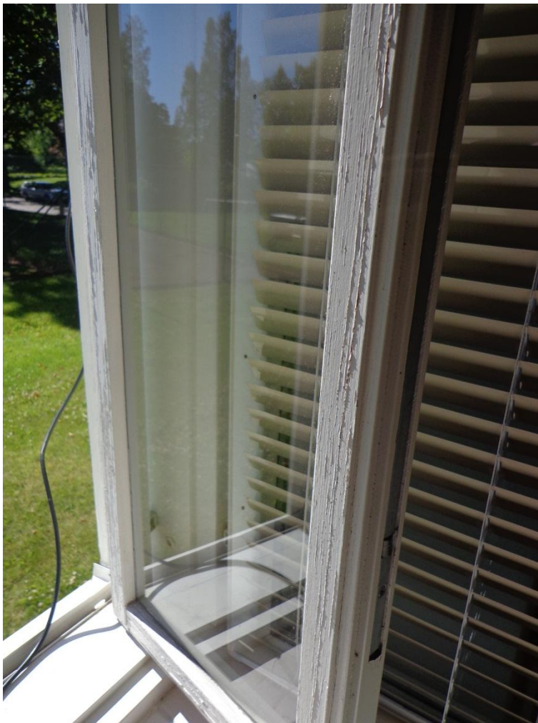
Kuva 62. Ikkunat tulisi vähintään huoltomaalata pidemmän käyttöiän saavuttamiseksi.
