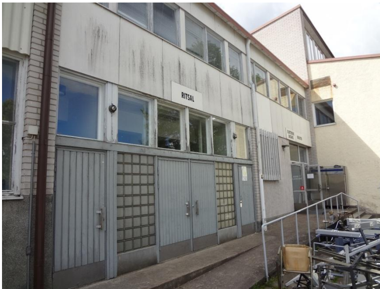
Kuva 104. Rakennuksen 1 ulkovalaisimet ovat huonokuntoisia.
