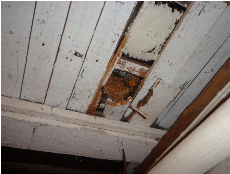
Kuva 89. Välipohja tulisi saneerata.
