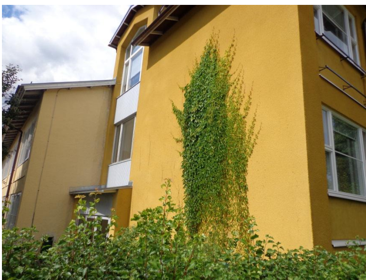
Kuva 4. Köynnös saattaa vaurioittaa seinän rappausta
