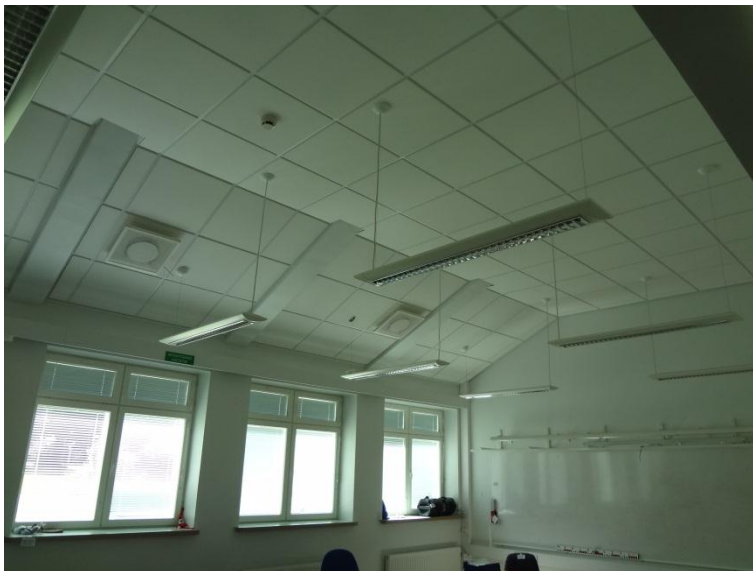
Kuva 78. Rakennuksen 6 valaistusjärjestelmät ja sähkökojeet ovat hyväkuntoisia.
