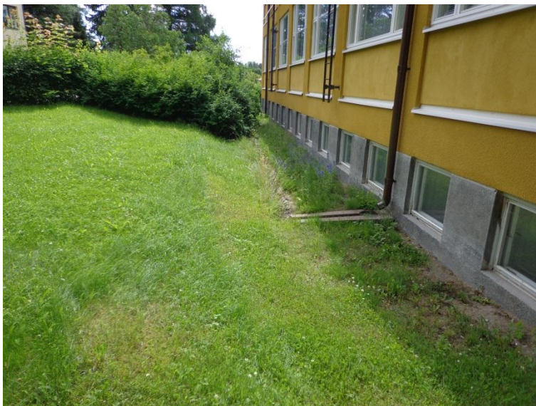
Kuva 5. Seinustalta ei löytynyt patolevyjä, jotka vähentäisivät seinän kosteusrasitusta
