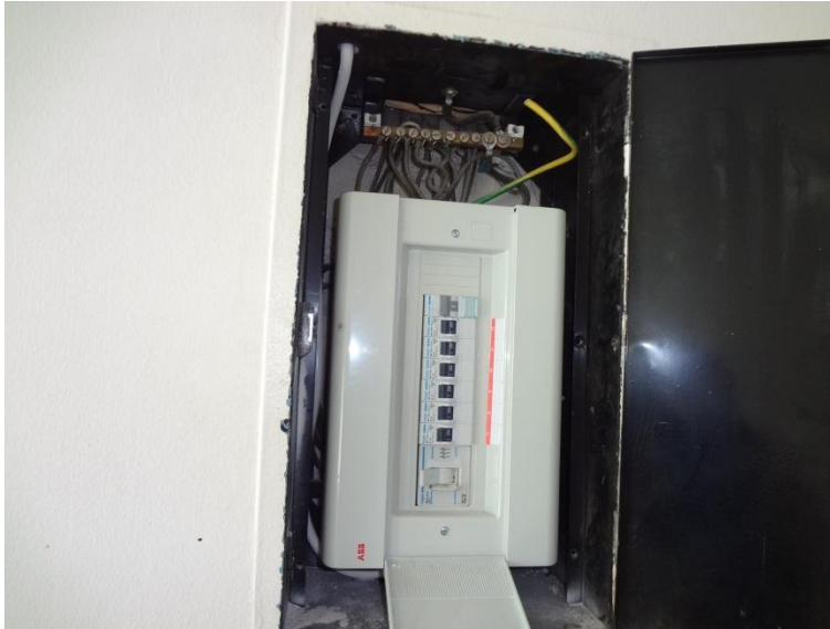
Kuva 13. Porrashuoneessa sijaitsevat ryhmäkeskukset ovat uusittu, mutta kaapeloinnit ovat alkuperäisiä
