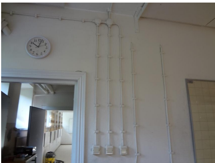
Kuva 12. Luokkatiloissa on käytössä vielä alkuperäisiä kaapelointeja
