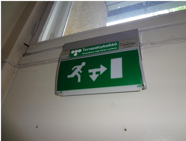
Kuva 46. Osa poistumistieopasteista on uusittu ja varustettu turvavaloyksiköillä, käytössä on myös vanhoja ovimerkkivalaisimia.
