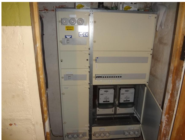
Kuva 79. Kiinteistön sähköpääkeskus on uusittu vuonna 2007.
