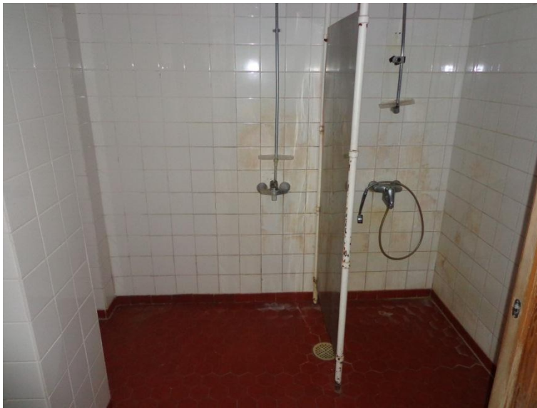
Kuva 40. Kellarin pesutilat ovat erittäin heikossa kunnossa
