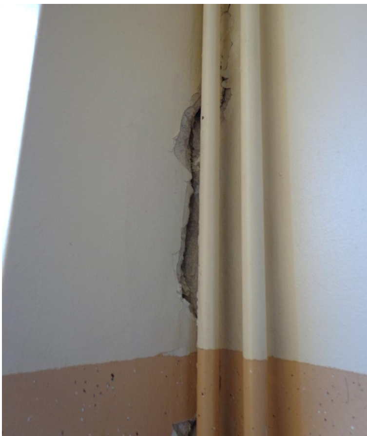
Kuva 3. Halkeama A- ja B-osan välisessä seinässä
