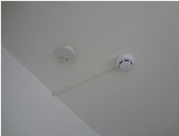
Kuva 48. Rakennuksessa 2 on Paradox kulunvalvontajärjestelmä ja tilat on suojattu palovaroittimin.
