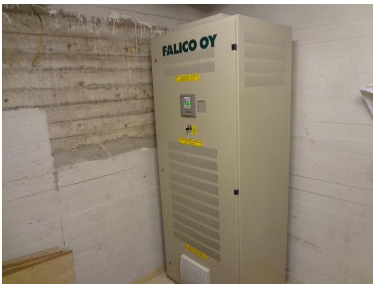
Kuva 24. Pääkeskukseen on liitetty automaattinen 150 kVar komensointiparisto
