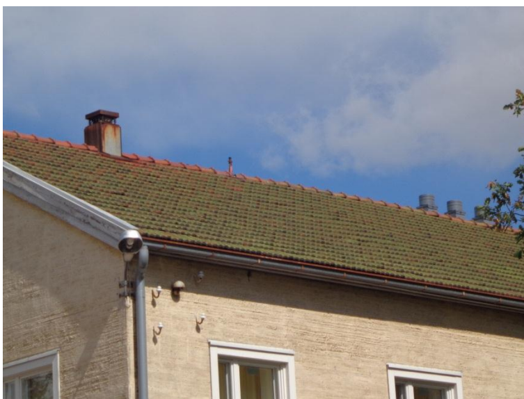
Kuva 64. Vesikatolla kasvaa reilusti sammalta.
