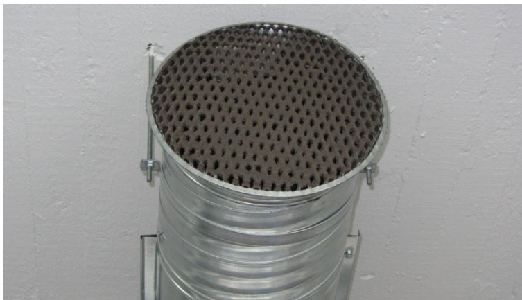
Kuva 21. Poistoilmaritilä on puhdistuksen tarpeessa.
