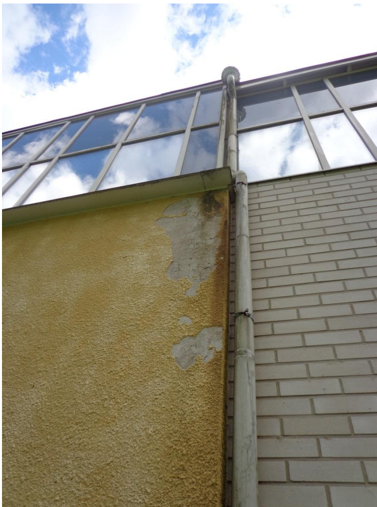
Kuva 53. Syösyjen vuodot tulisi korjata ennen suurempien vaurioiden ehkäisemiseksi.
