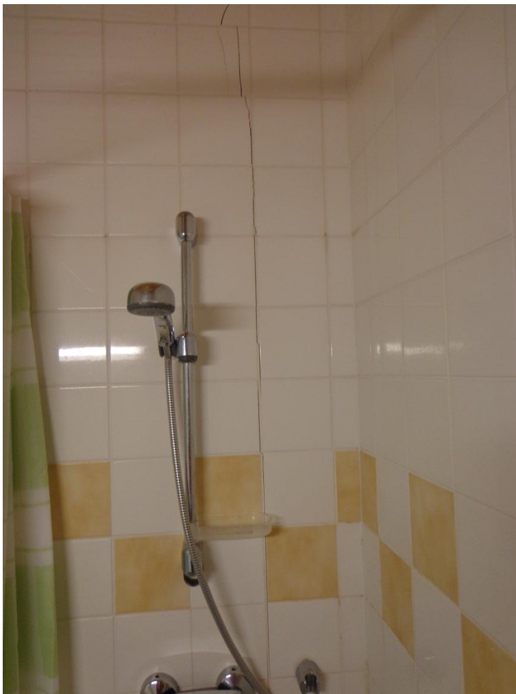
Kuva 63. Toisen kerroksen pesuhuoneessa halkeama seinässä.
