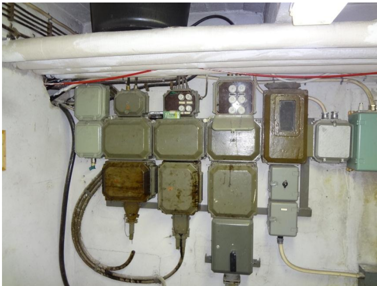
Kuva 26. Alkuperäinen sähkökeskus kellaritilassa on purettavassa kunnossa.
