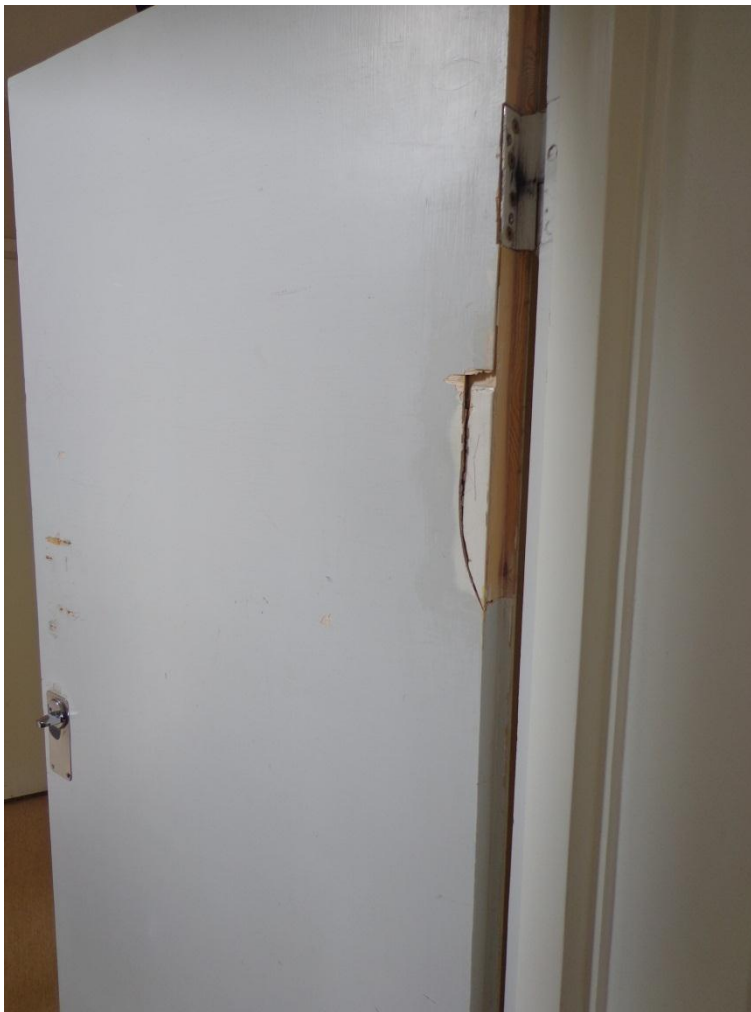
Kuva 39. Huoneistojen ulko-ovet ovat huonossa kunnossa
