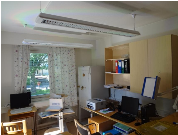
Kuva 69. Rakennuksen 5 sähköasennukset ja kojeet ovat hyväkuntoisia, 2-kerroksen asennukset ja kojeet on suositeltavaa saneerata 1-kerroksen tasoon.
