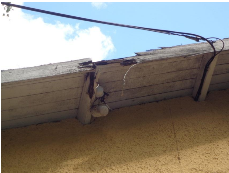
Kuva 92. Katto on suositeltavaa uusita kokonaisuudessaan.
