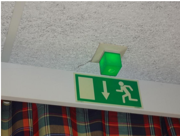
Kuva 58. Rakennuksen turva- ja poistumistie opasteet tulee uusia nykyisen standardin mukaisiksi mikäli rakennuksessa tehdään rakennuslupaa edellyttäviä toimenpiteitä.
