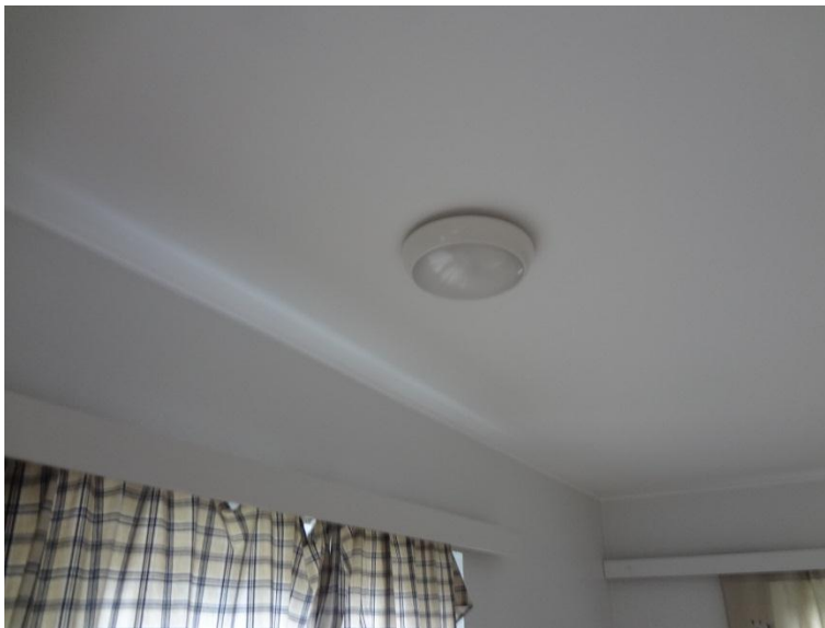
Kuva 47. Suuri osa rakennuksen kiinteistä valaisimista on uusittu vanhaan kaapelointiin, mutta rakennus on sähköverkon kokonaissaneerauksen tarpeessa.
