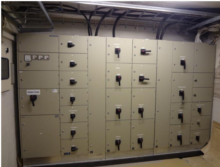
Kuva 23. Koko rakennusryhmän pääkeskus on asennettu vuonna 2004 ja on hyödynnettävissä myös rakennuksen käyttötarkoituksen muuttuessa.
