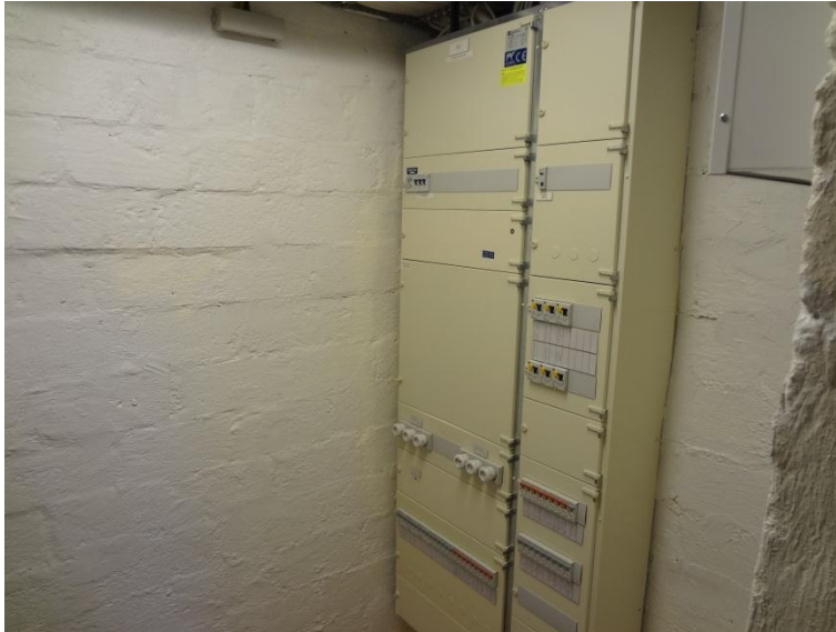
Kuva 67. Ryhmäkeskus RK-1 on uusittu n. vuonna 2007. Rakennuksessa on myös toimistotilat kattava Cat 5 yleiskaapelointijärjestelmä.
