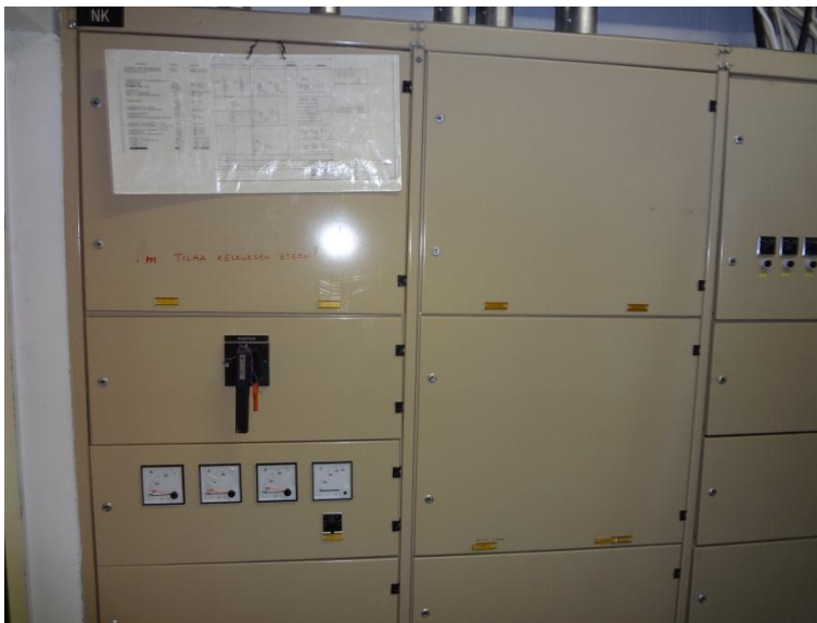
Kuva 55. Rakennuksen 3 nousukeskus on TN-C järjestelmän mukainen ja asennettu vuonna 1986 – rakennuksen käyttötarkoituksen säilyessä keskusta ei ole tarpeen uusida 10-vuoden tarkastelujakson aikana.
