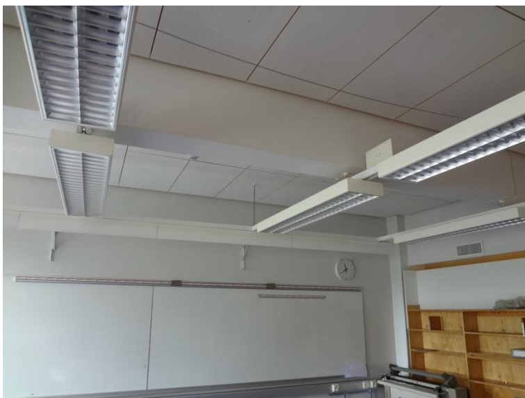
Kuva 36. Tilojen valaisimet ja valaistusryhmäjohdot ovat hyväkuntoisia.
