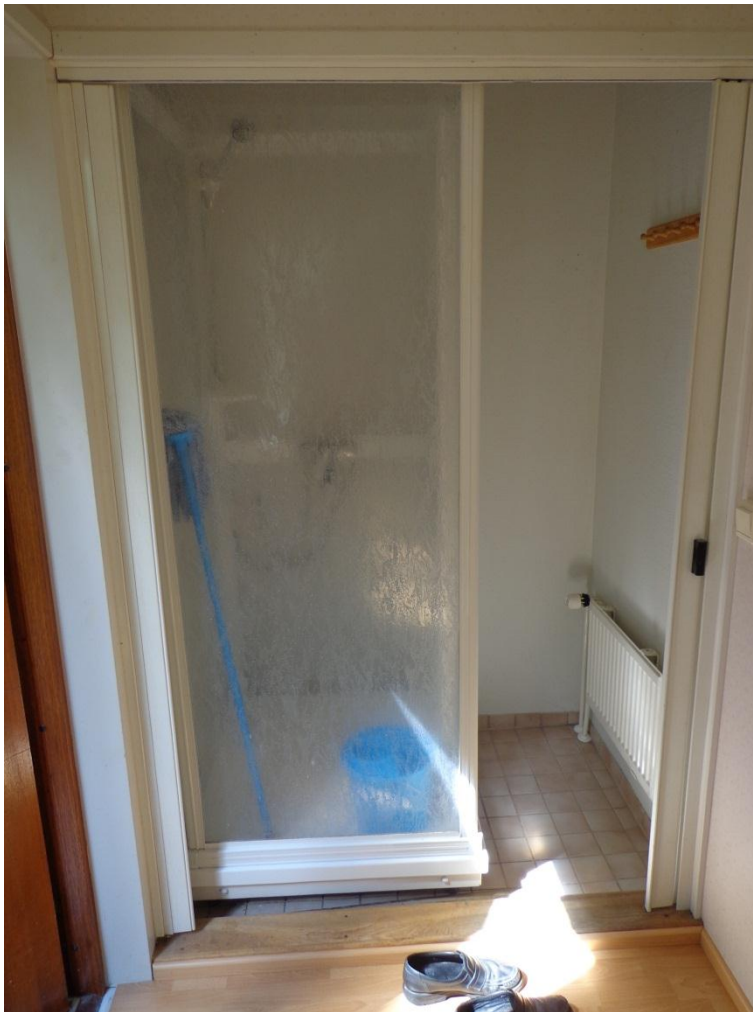
Kuva 91. A-huoneiston parannettu suihkukoppi. Suihku tulisi rakentaa nykyvaatimusten mukaiseksi.
