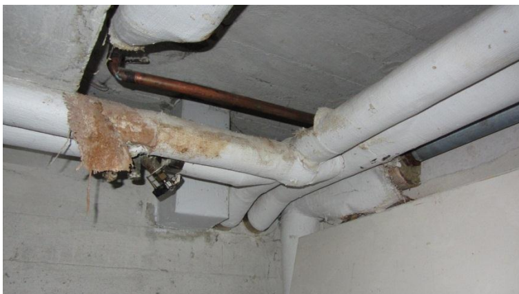
Kuva 42. Putkieristeiden kunto on melko heikko
