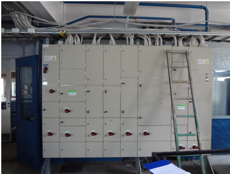
Kuva 27. Suuri osa rakennuksen 1 osan B sähkökeskuksista on hyväkuntoisia ja hyödynnettävissä myös tilojen käyttötarkoituksen muuttuessa.
