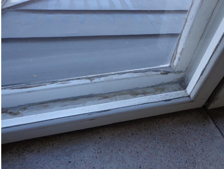
Kuva 1. Alkuperäisten ikkunoiden maalipinta hilseilee
