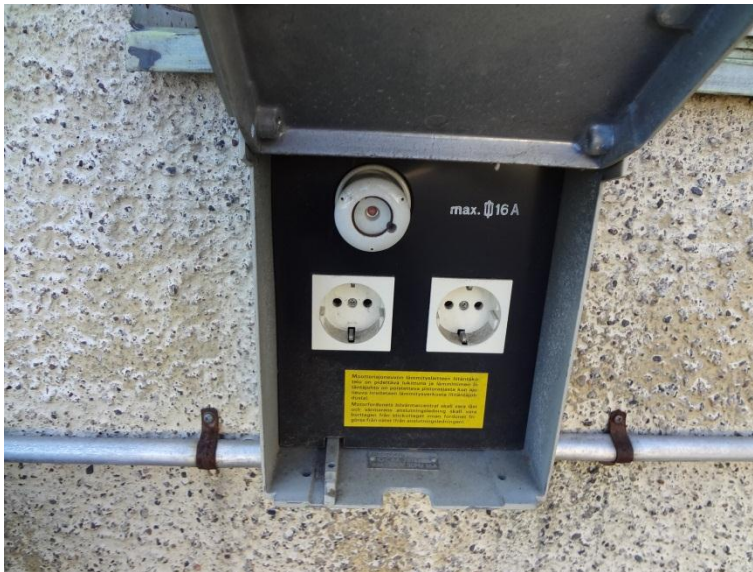
Kuva 105. Autolämmityspistorasiakotelot ( rakennus 1A ) on suositeltavaa uusita vikavirtasuojatuiksi.
