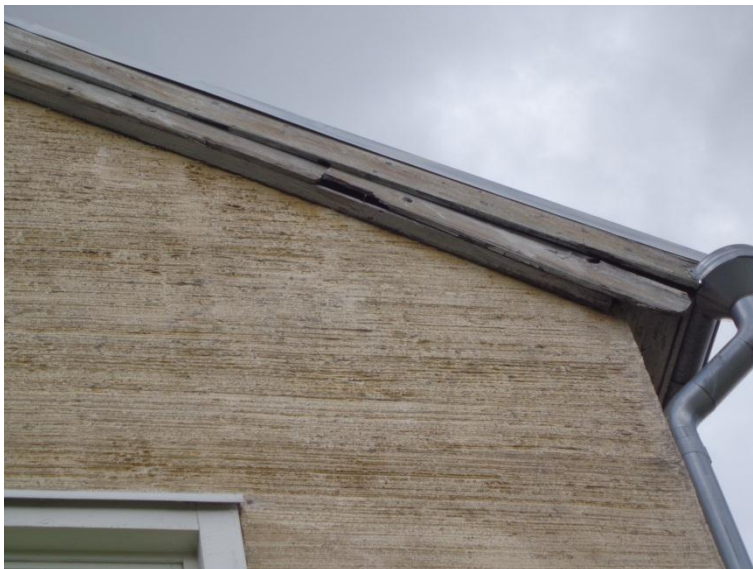
Kuva 66. Räystäiden puuosat ovat erittäin huonokuntoiset.
