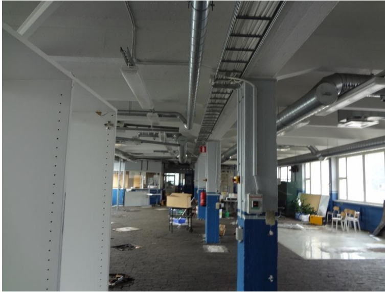
Kuva 29. Rakennuksen 1 osan B kaapelihyllyjä ja valaisinripustuskiskoja on hyödynnettävissä myös tilojen käyttötarkoituksen muuttuessa.
