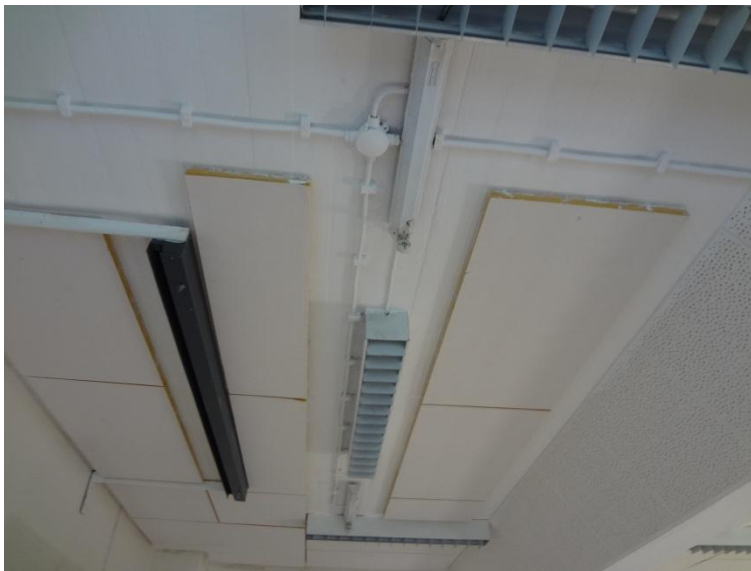
Kuva 14. Sähköasennukset ja kojeet ovat kokonaissaneerauksen tarpeessa
