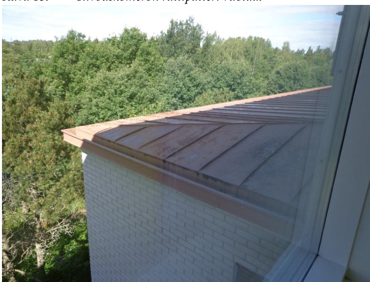
Kuva 16. Peltikatto tulisi huoltomaalata.
