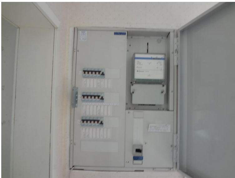
Kuva 99. Asunnon A ryhmäkeskus ja sähkökojeet on uusittu vuonna 2012.
