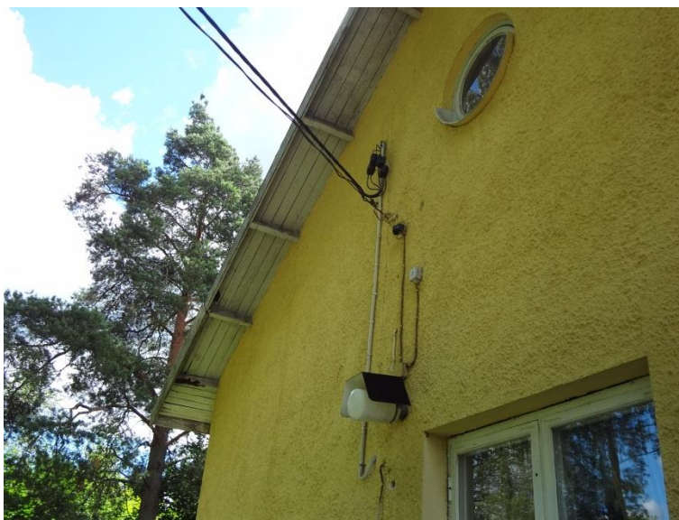
Kuva 97. Kiinteistön sähköliittymisjohto on suositeltavaa muuttaa maakaapeliksi sähköverkon kokonaissaneerauksen yhteydessä.
