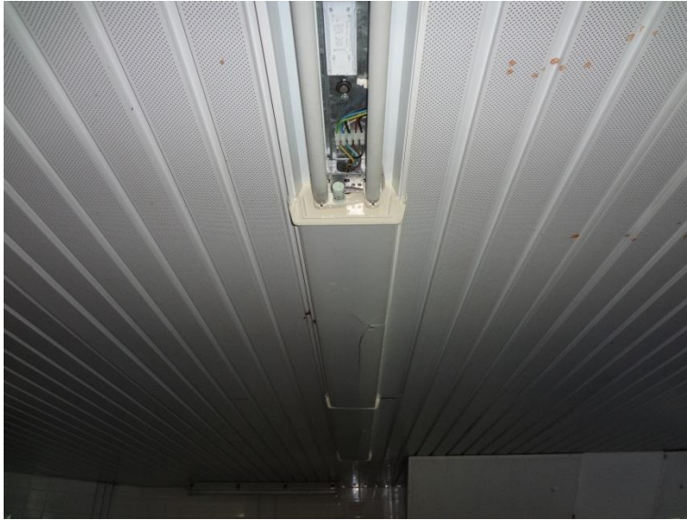
Kuva 59. Osa opetustilojen valaisimista on huollon tarpeessa.
