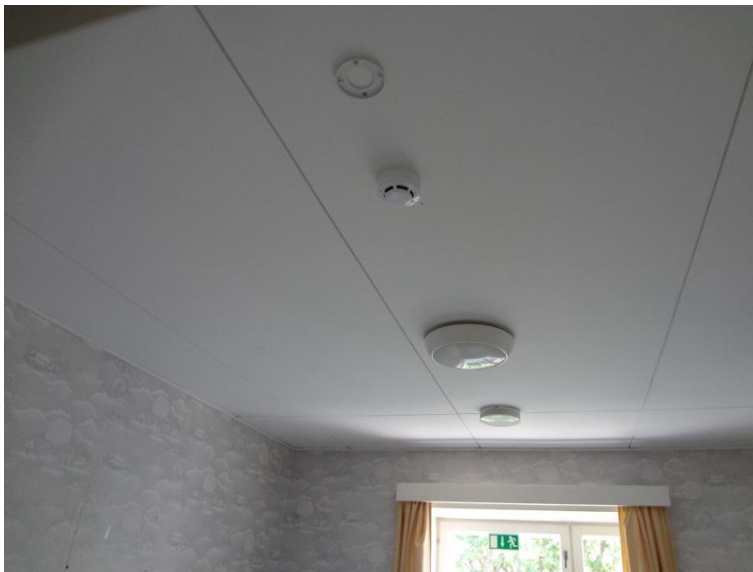
Kuva 70. Rakennuksessa 5 on Paradox kulunvalvontajärjestelmä ja tilat on suojattu palovaroittimin.
