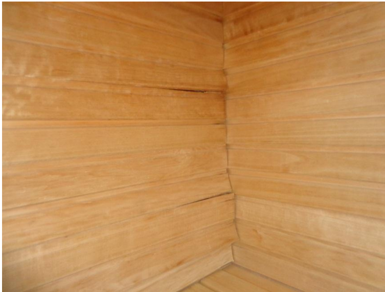
Kuva 61. Saunan panelointi on osittain irti seinärakenteista.
