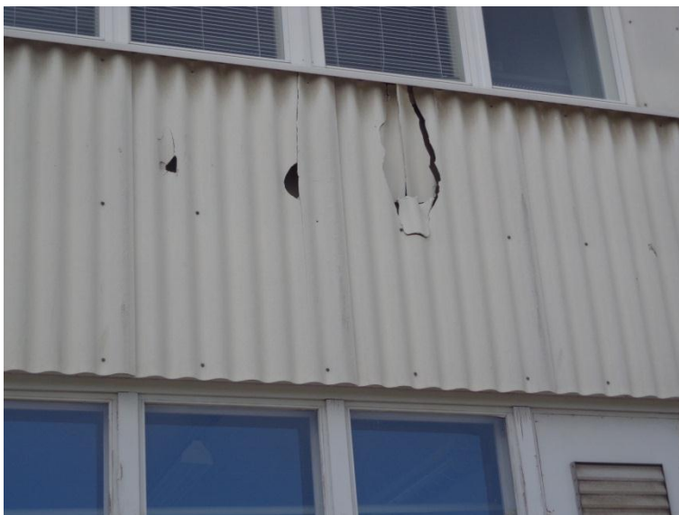
Kuva 18. Levypinnat ovat halkeilleet.
