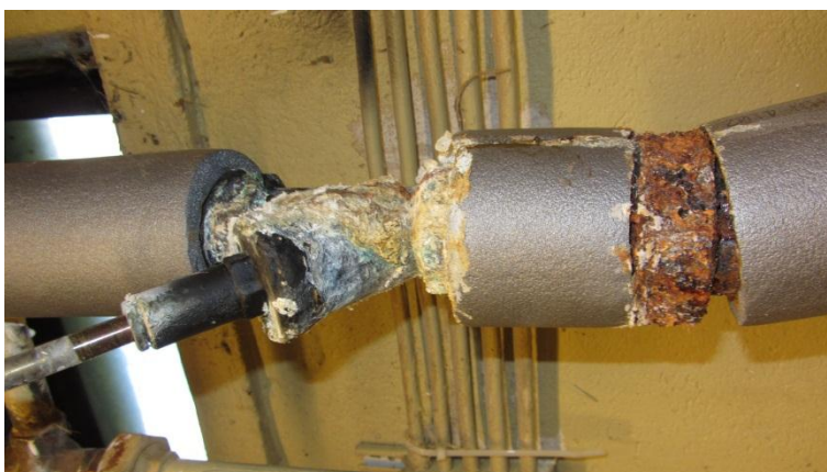
Kuva 83. Säätoventtiili on huonossa kunnossa
